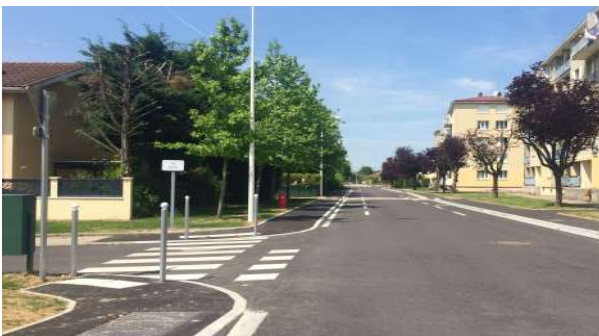
Rue Paul VERLAINE (2021-02/2022) : réfection chaussée, création et mise aux normes de trottoirs ; travaux cofinancés (Bourg, Péronnas et Grand Bourg Agglomération)
